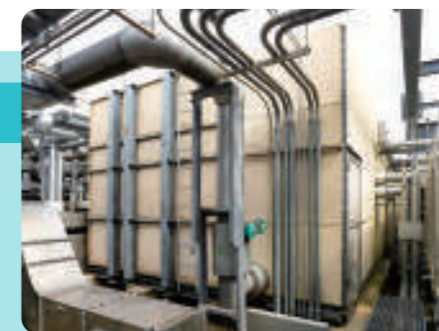
ビル屋上に設置されている既設の氷蓄熱槽
