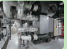
コージェネレーションシステム(CGS)
