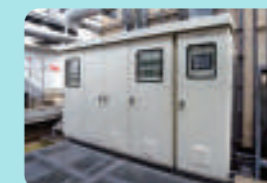
新設された制御盤
