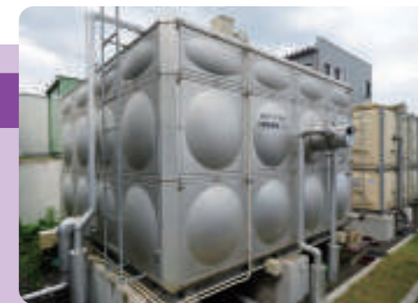
熱源システム横に設置された貯湯槽
