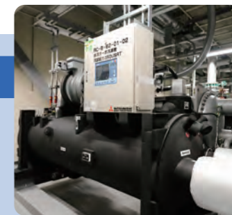
水冷式ターボ冷凍機
