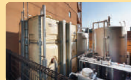
左から源泉槽、貯湯槽(ヒートポンプ用)、太陽熱蓄熱槽
