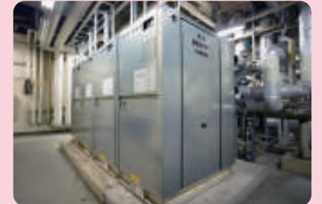
館内に新設された熱回収ヒートポンプ
