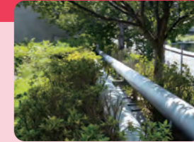
景観に配慮し植栽で目隠した屋外配管
