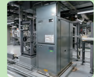
下水再生水熱利用ヒートポンプ
