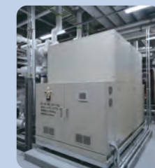
井水熱利用ヒートポンプチャラー
