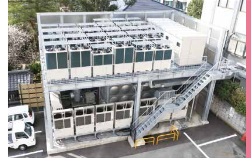
蓄熱設備全景。1階に業務用エコキュートと貯湯槽、2階に受変電設備が設置されている
