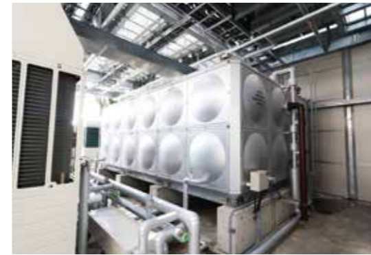
業務用エコキュート貯湯槽(32m 3 )
