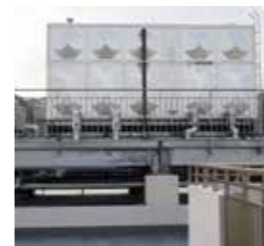
浴室用の開放型貯湯槽(42トン)
