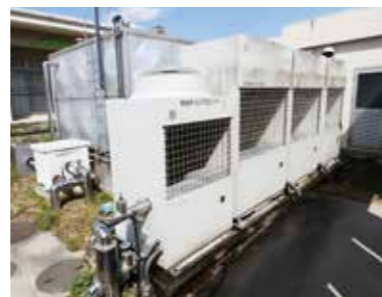
手前が空冷チラー、奥が業務用エコキュート
