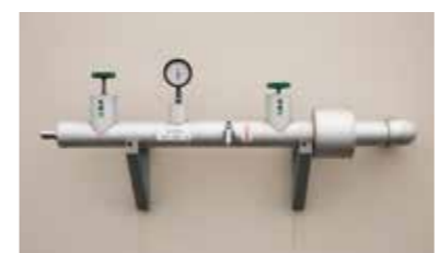
大規模温度成層型蓄熱槽の壁面に設置した緊急用水栓
