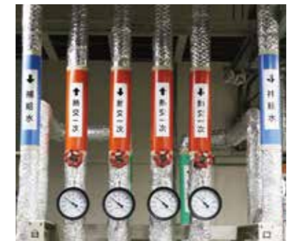
冷水が流れるパイプ
