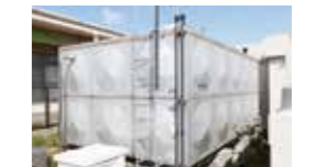
業務用エコキュートの貯湯槽(30m 3 )
