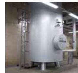
厨房用の密閉型貯湯槽(6トン)
