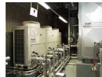
ヒートポンプ給湯機と貯湯槽(18m 3 )
