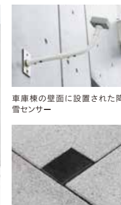
車庫棟の壁面に設置された降雪センサー
