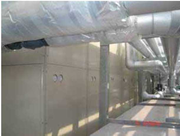
井水熱源水冷式ヒートポンプ(62.5HP+60HP)
