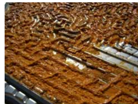
プレート式熱交換器の汚れ
