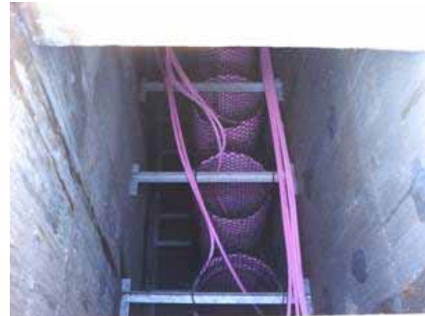
図 浄化槽熱交換器
