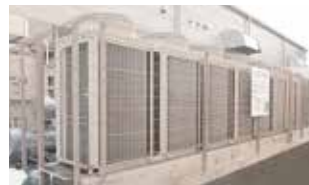
ヒートポンプチラー
