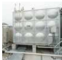
ヒートポンプ給湯
