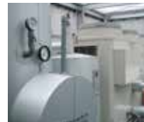
風呂温水クッションタンク
