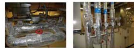
図-5,AHU運転変更とバルブリーク対策② バルブユニット変更
