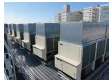
空気熱源ヒートポンプチャラー
