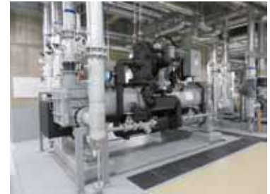
ターボ冷凍機
