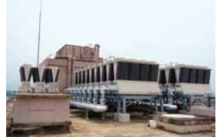
空気熱源ヒートポンプチラー
