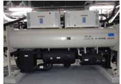
タワー冷凍機
