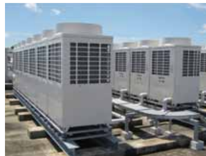
電気式ヒートポンプ (個別分散)
