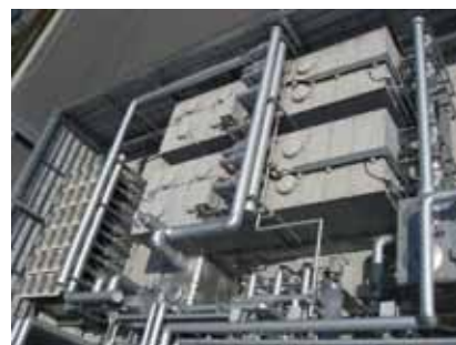
生産プロセス用冷却水蓄熱システム
