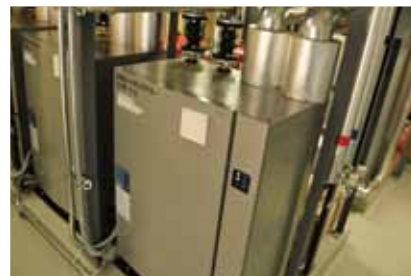
地中熱源ヒートポンプチラー
