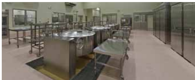
もりよし学校給食センター電化厨房
