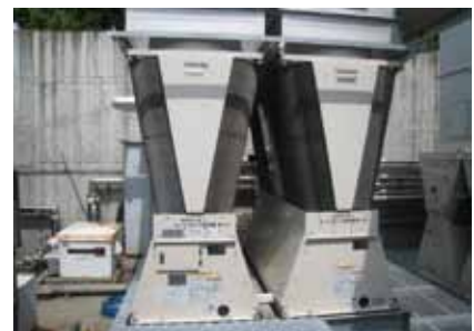
循環加温ヒートポンプ
