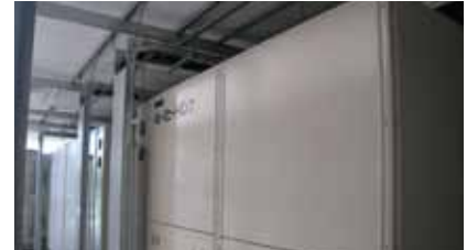
地中熱源ヒートポンプチラー
