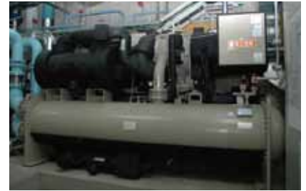
ターボ冷凍機
