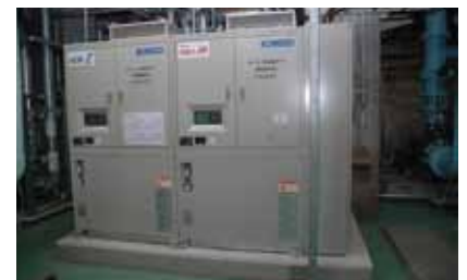
排熱回収ヒートポンプ
