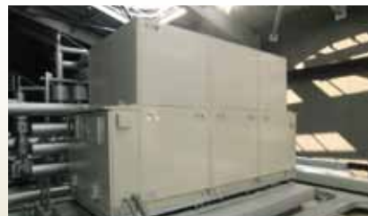
井水熱源ヒートポンプ
