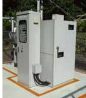
排熱回収ヒートポンプ(追設)
