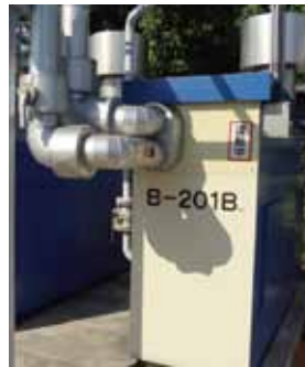
既設温水ヒータ
