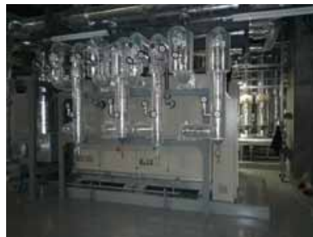
ヒーティングタワーヒートポンプ
