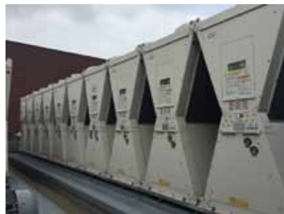
空気熱源ヒートポンプチラー
