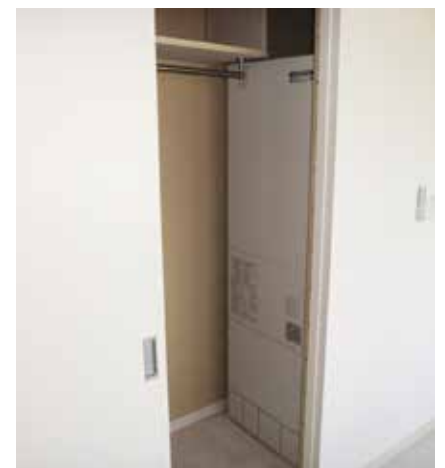
貯湯ユニット
