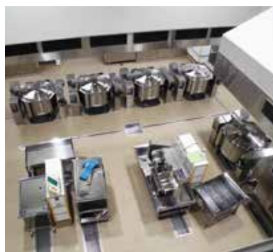
電化厨房機器を採用した調理室
