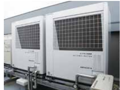
業務用エコキュート室外機
