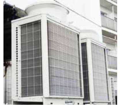
業務用エコキュート室外機
