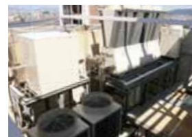
空冷HPと蓄熱槽
