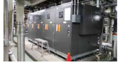
冷温同時ヒートポンプ
