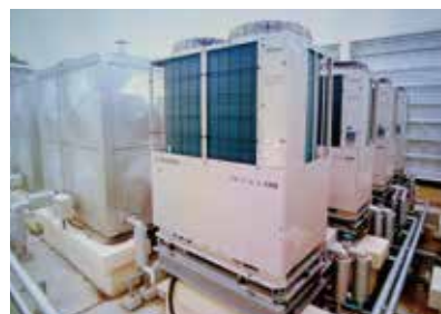
業務用エコキュート室外機
