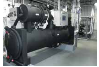
ターボ冷凍機
