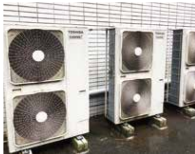
循環加温ヒートポンプの室外機
