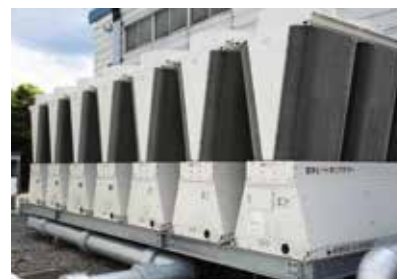
空冷ヒートポンプチャラー
