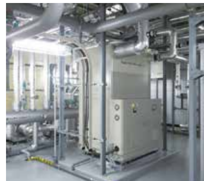
地中熱対応水冷ヒートポンプチラー
