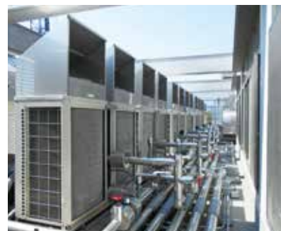
ヒートポンプチラー
