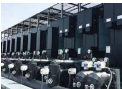
空冷ヒートポンプチャラー
