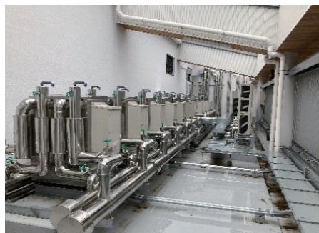
地中熱ヒートポンプ
