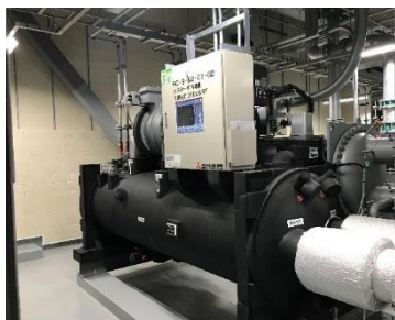
図2 ターボ冷凍機
