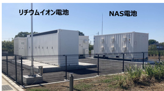
竣工後に増設した蓄電池
