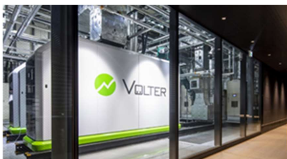
バイオマスガス化発電機
