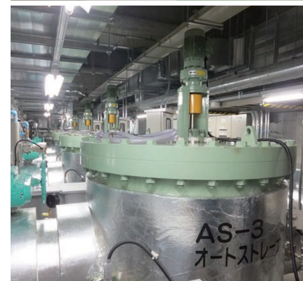
④ビルの地下には限られたスペースに整然と機器が配置されている ⑤河川水のゴミや砂などを除去するオートストレーナー
