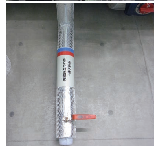
④中温冷水と冷水配管。熱のカスケード利用で「戻り冷水」を有効に使っている ⑤BCP対応用の配管。蓄熱槽からの水を清水建設の受水槽へと切り替える
