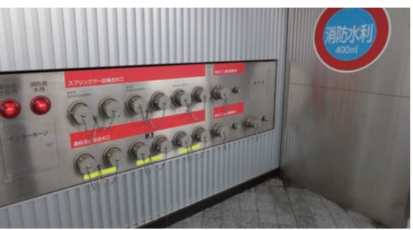
スカイツリーの蓄熱水は消防水利としても利用できる
