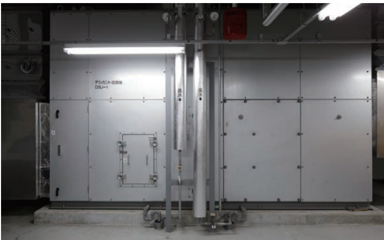
プール室内の除湿を管理するデシカント空調設備
