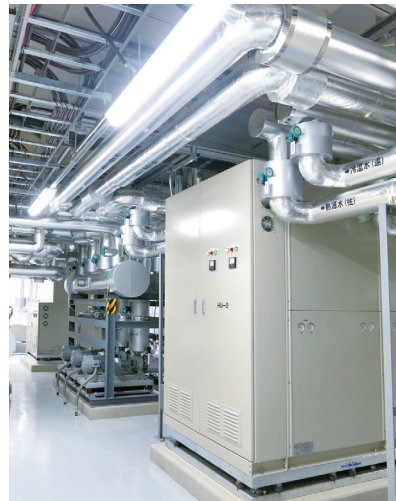
地中熱ヒートポンプ
