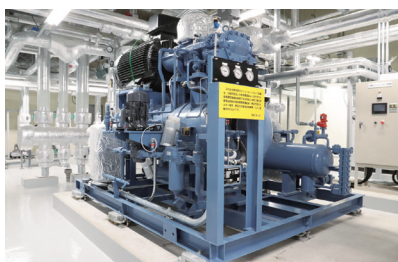
地中熱ヒートポンプ
