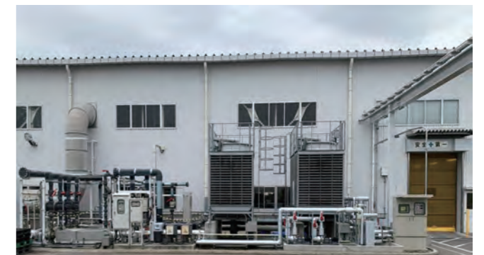
ヒートポンプチラー設置状況
