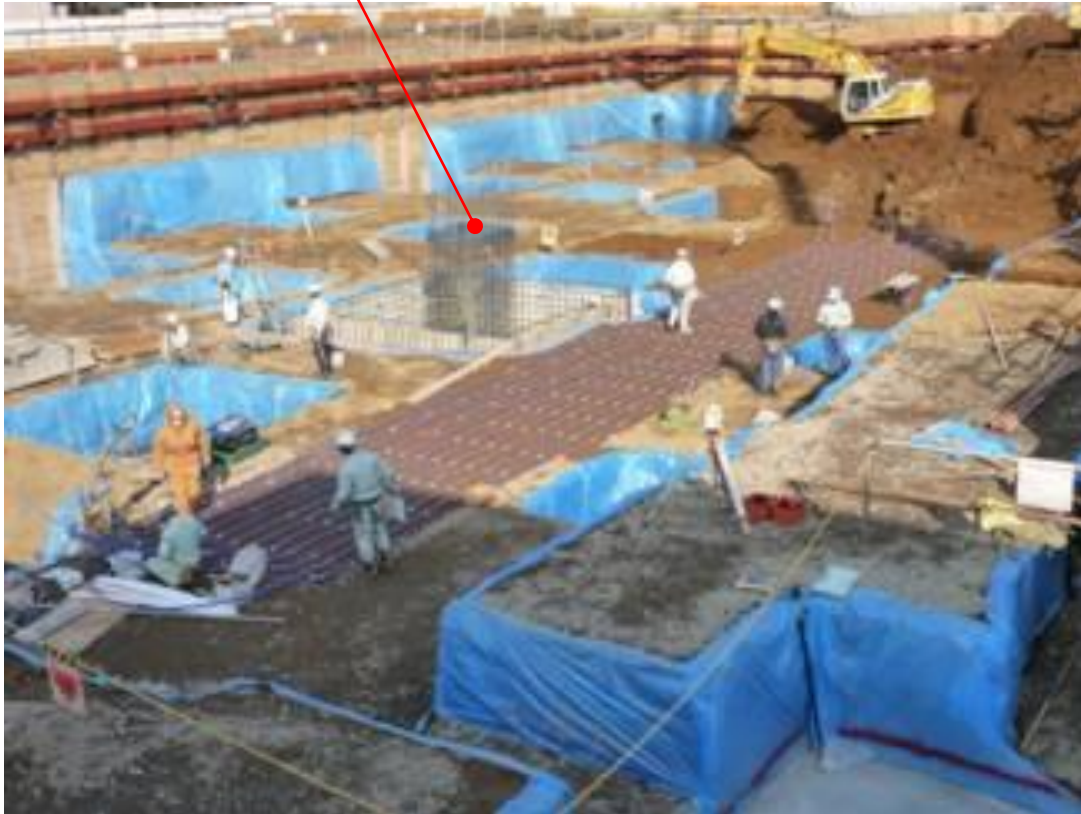
水蓄熱槽直下に埋設
