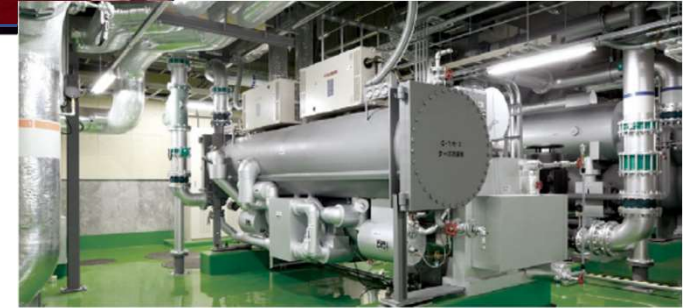
45℃排熱回収ダブルバンドル式ターボ冷凍機を採用
