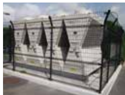
神栖海浜温水プール 空冷ヒートポンプチャラー
