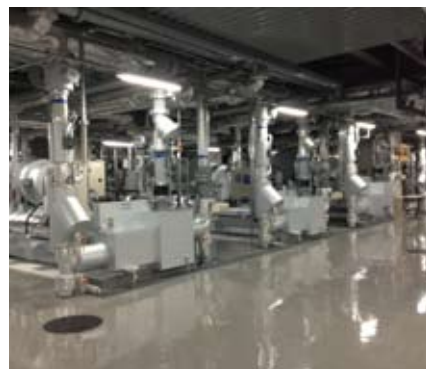
インバーターボ冷凍機
