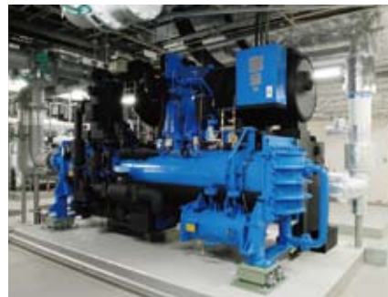
インバーターボ冷凍機
