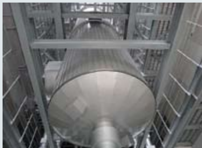
建物に据え付けられた連結式縦型蓄熱層
