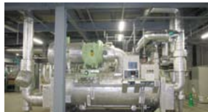
ターボ冷凍機
