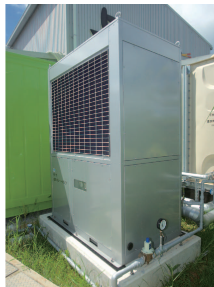
冷温同時取出ヒートポンプ
