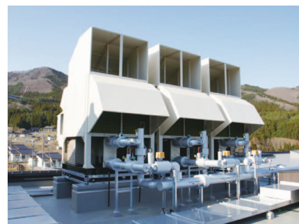
空気熱源ヒートポンプチラー
