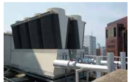
空気熱源ヒートポンプチラー
